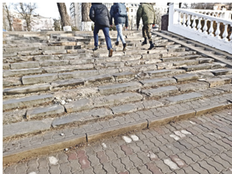
■ Лестница в парке Горького находится в аварийном состоянии
